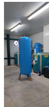
Air compressor area.jpg
